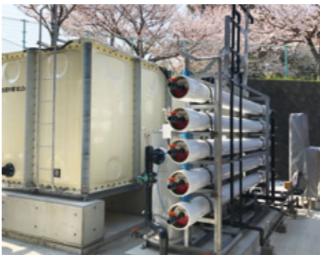
温泉施設の排水回収装置
