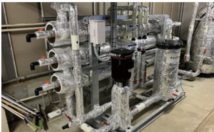
病院や工場に納入している井水浄水設備
